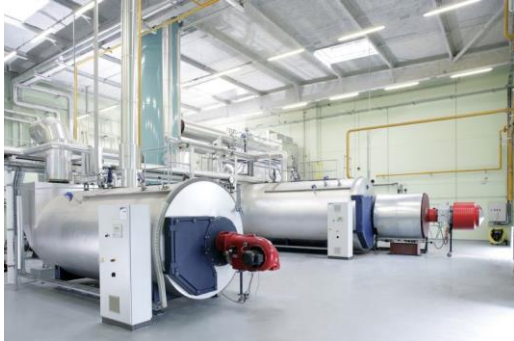
Duurzaam ondernemen bij MEWA: stoomketelinstallaties met rookgaswassers
